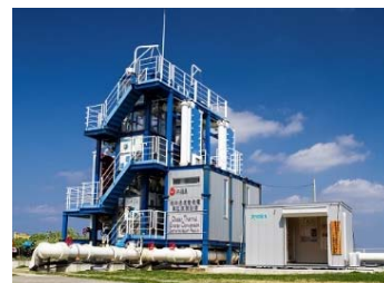
沖縄県の100kW級海洋温度差発電実証プラント
